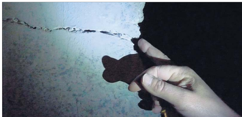
Die Steine im Untergrund der Luisenburg arbeiten. Daher treten immer mal wieder Risse auf.
